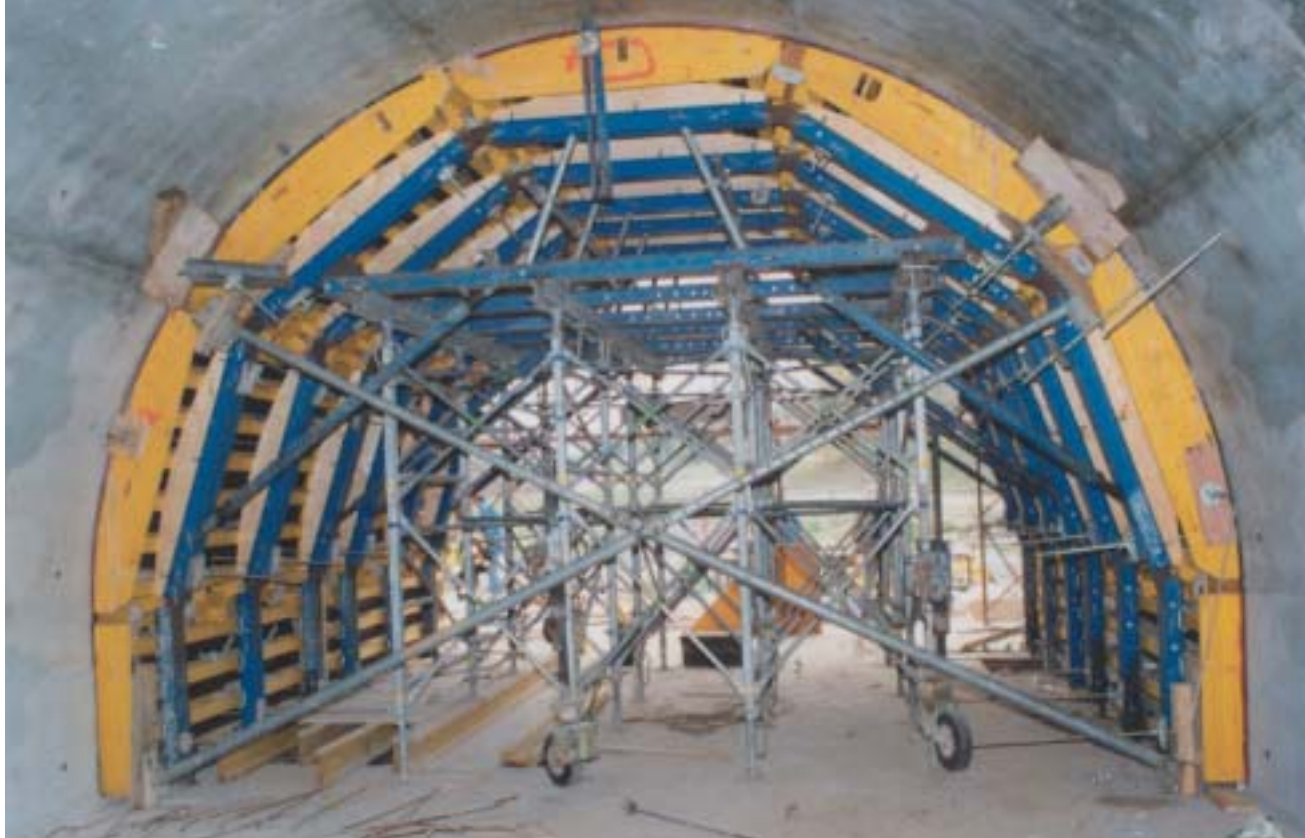
Les tours d'étaie Staxo soutiennent les panneaux coffrants Top 50 à rayon fixe qui permettent d'obtenir la forme de voûte intérieure. L'ensemble se ripe à l'aide des accessoires de translation amovibles.
