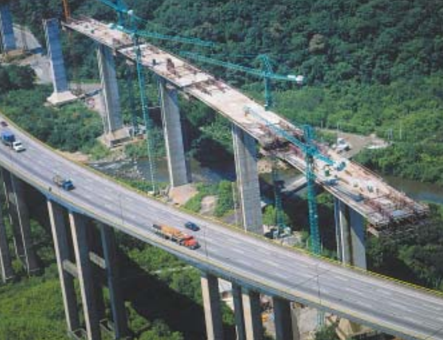
Chantier : Viaduc VD 7, Brésil Entreprise : Consorcio Imigrantes - JV CR Almeida (Brésil) & Impregila (Italie)
