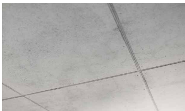
Labā betonēšanas kvalitāte
