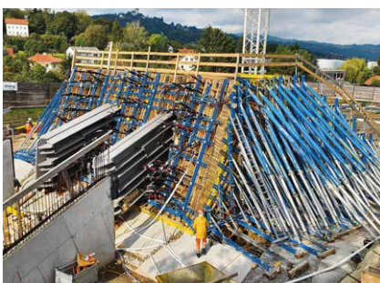
Temperaturüberwachung in Massenzement
