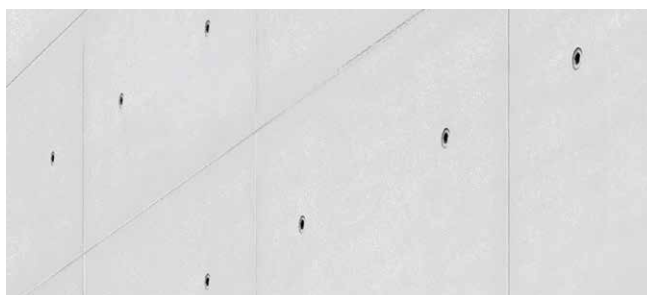
Aspect atractiv al betonului
