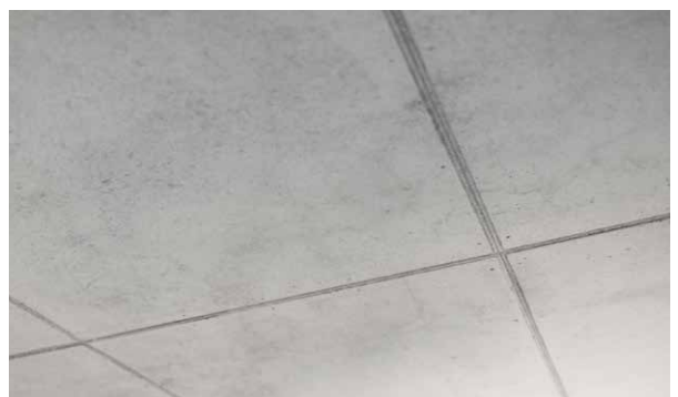
Geras betono paviršius.
