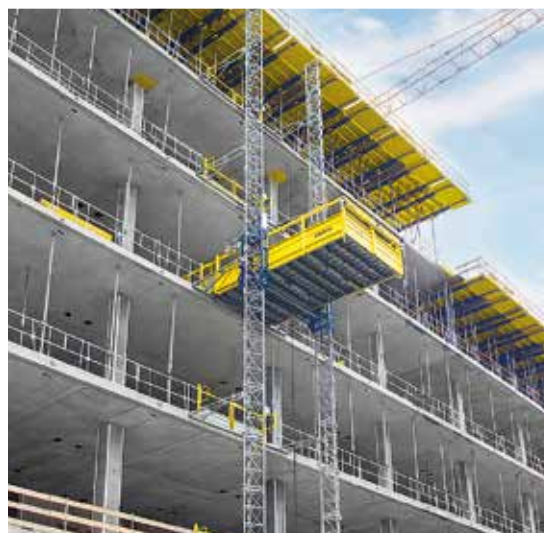
Schnelle Bauabläufe ohne Kran: Mit dem Tischhubsystem TLS werden Deckentische auf Knopfdruck ins nächste Geschoss gebracht.
