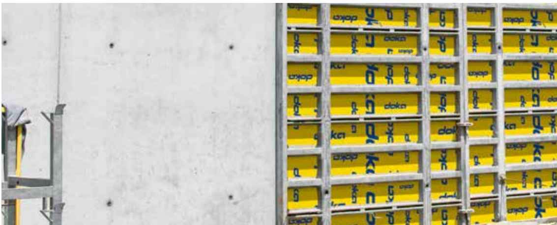
Das Betonbild der Framax Xlife zeichnet sich aus durch eine ebene und saubere Oberfläche mit geordnetem Fugenbild ohne Abdrücke der Plattenbefestigung
