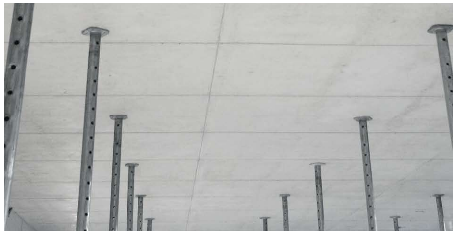
Deckenuntersichten, die sich sehen lassen können. Die Xlife-Platte sorgt für glatte Oberflächen, der Rahmen für ein ästhetisches und sauberes Fugenbild.
