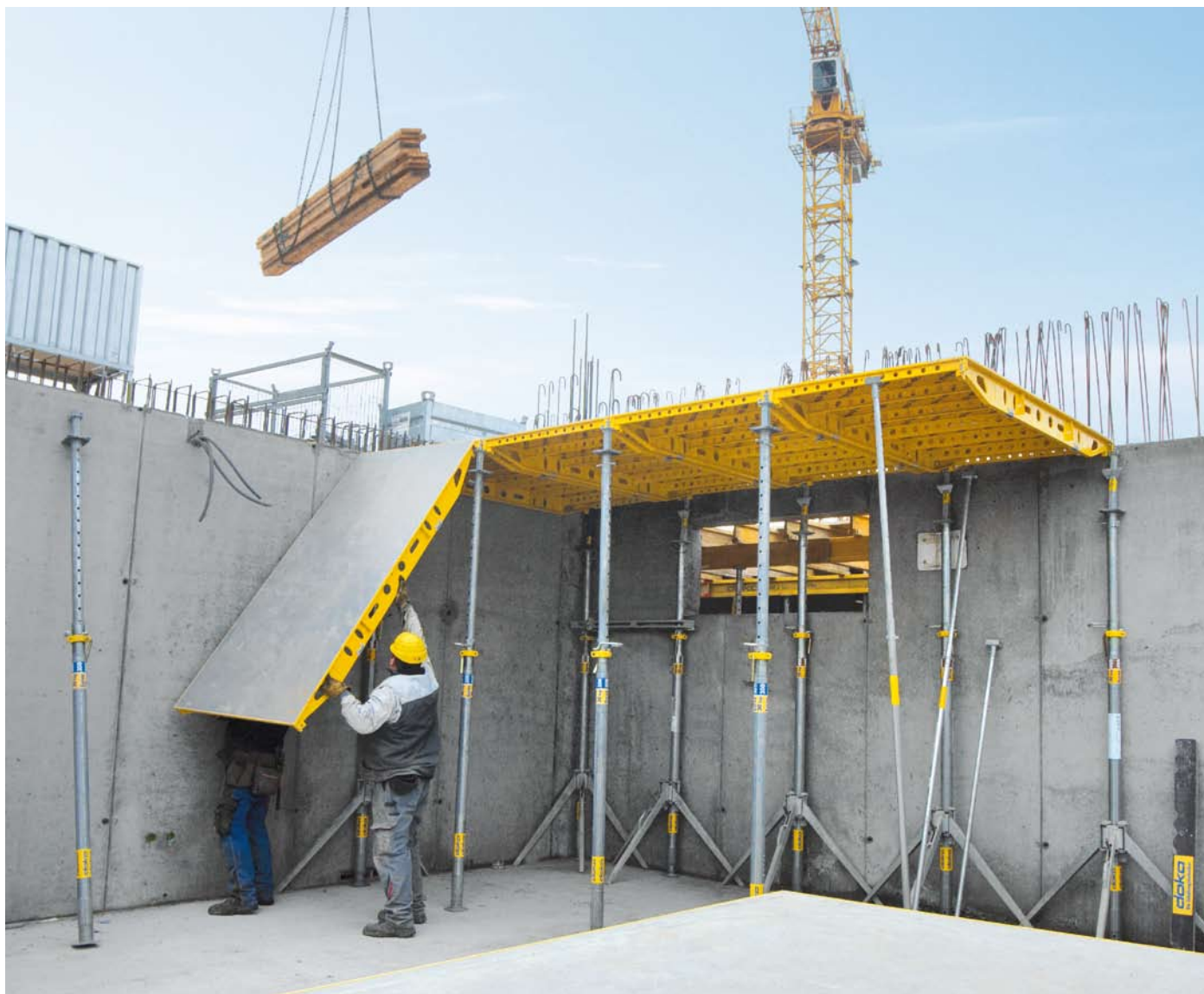
Ręczny montaż z dołu: Ogranicza to czas pracy dźwigu i pozwala go wykorzystać do wykonywania innych robót. Przyspiesza to znacznie realizację budowy.
