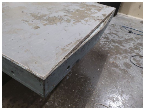
Keretprofil horpadása > 2 mm
