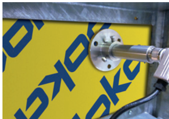
Elementy pomiarowe czujników kablowych są wbudowywane bezpośrednio w poszycie deskowania i razem z nim przestawiane.
