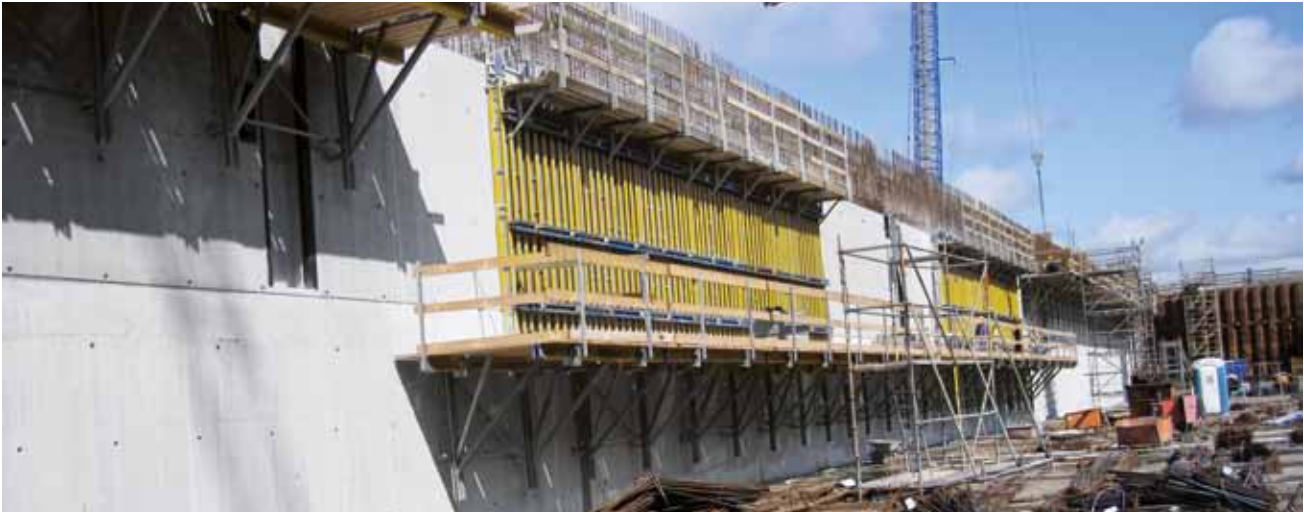
▲ Im Pilgerschritt-Verfahren werden mit der Trägerschalung Top 100 tec jeweils 15 m lange und 3,90 m hohe Wandabschnitte betoniert.
