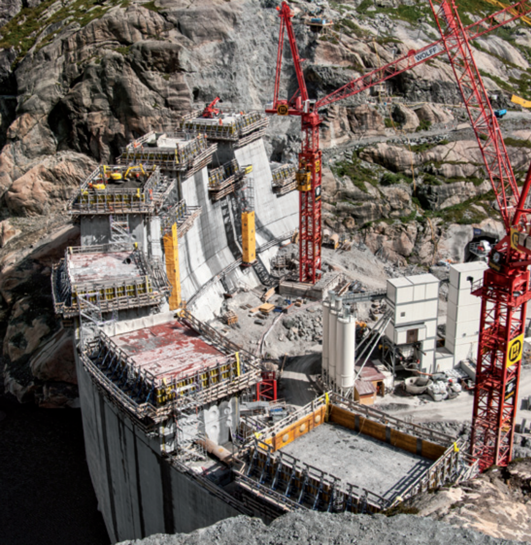
▲ 坝顶长 170 m 的重力坝采用多卡经过验证的水坝模板 D15 进行建造。
