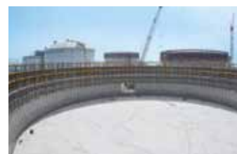
▲ 储罐内径达到 78m。
