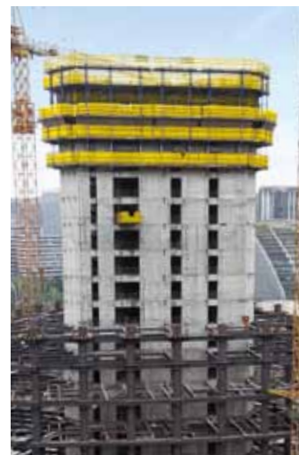
▲ Dokaは、プロジェクトにセルフクライミング型枠 SKE50およびTop 50ラージエリア型枠を供給して、タワークレーンに要する時間を短縮し、建設の進行速度を上げています。
