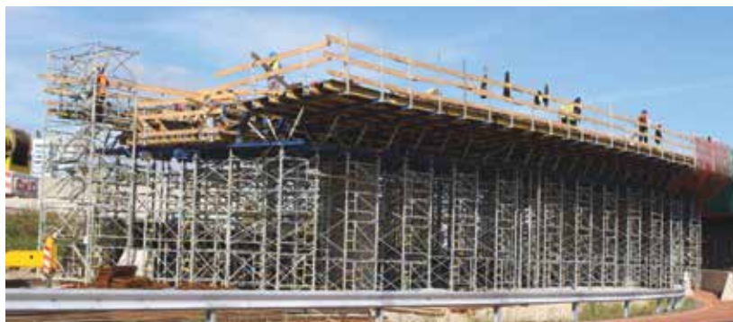
Bezpečný výstup na mostovku zabezpečuje schodisková veža 250
