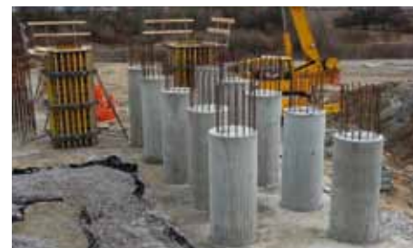
▲ Predĺženie pilót o 4 m nad terén sa realizovalo nasadením 2 zostáv nosníkového debnenia Top 50 doplneného o drevené ramenáty opláštené debniacou doskou 3-SO 21 mm.
