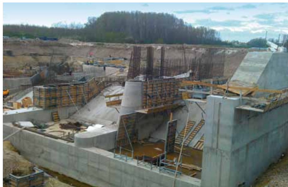
▲ Objekt Hať sa realizoval hlavne nasadením rámového debnenia Framax Xlife. Atypické tvary debnenia sa zhotovili presne na mieru v servise predmontáže debnenia.
