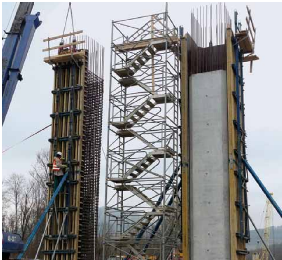
▲ Zhotovenie piliera pomocou zostavy nosníkového debnenia Top 50 s výškou 12,25 m. Bezpečný výstup na pracovisko zabezpečila stabilná schodisková veža 250.
