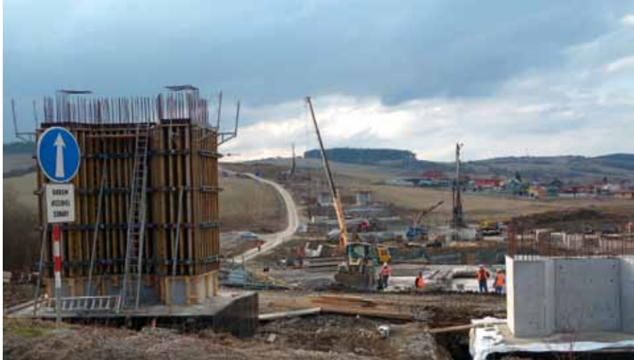
▲ Pomocou zostavy nosníkového debnenia Top 50 s výškou 5 m sa zhotovujú piliere v tvare kostičky s pôdorysným rozmerom 2,4 x 5 m.
