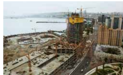
▲ Doka-samošplhacie systémy SKE50 a SKE100 poskytujú neobmedzený priebeh výstavby oboch výškových budov nezávisle od poveternostných podmienok.
