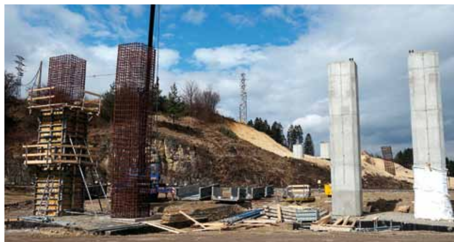
▲ Rôzne fázy výstavby pilierov pomocou rámového debnenia Framax Xlife doplneného o drevené ramenáty, ktoré vytvárajú požadovaný tvar piliera.
