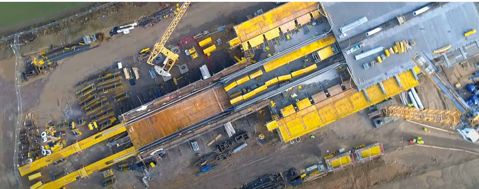
05 Pohľad na „výrobnú“ vysúvania a odliatie lamely mostovky na ceste I/36 Pardubice, Trnová – Fáblovka – Dubina.
