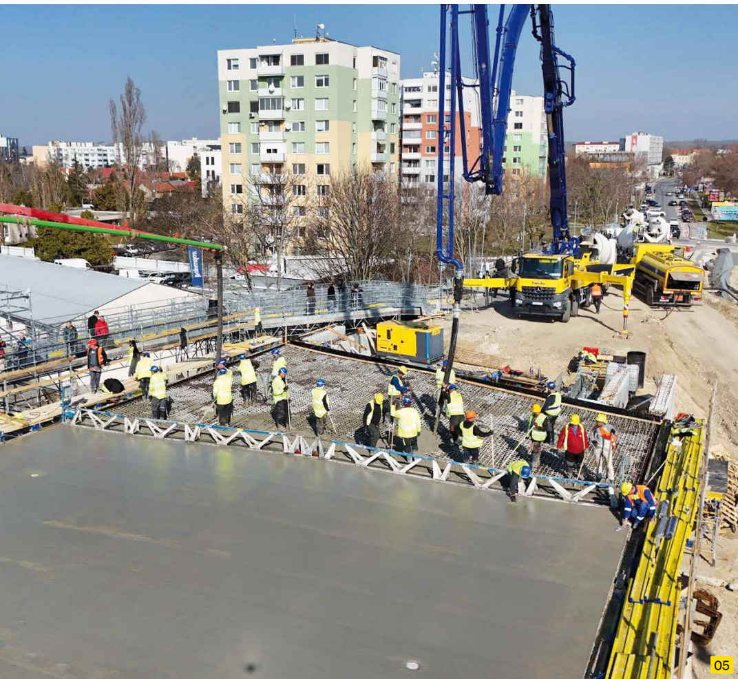
05 Debnenie čela mostovky vytvorené z nosníkového debnenia Top 50 muselo presne kopírovať hornú hranu konštrukcie mostovky, a to kvôli použitiu vibračnej vyrovnávacej laty, ktorá presahovala 15 cm za líniu bočného debnenia.
