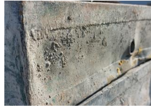
Frame profiel gedeukt
