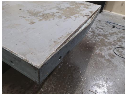
Frame profiel gebogen >2mm
