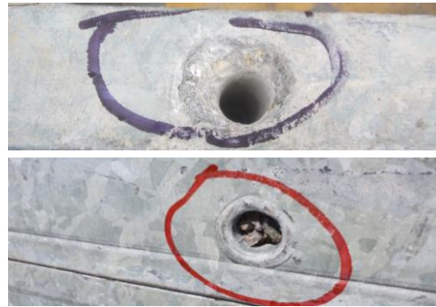
Profielverankeringsgaten beschadigd of gevuld met beton
