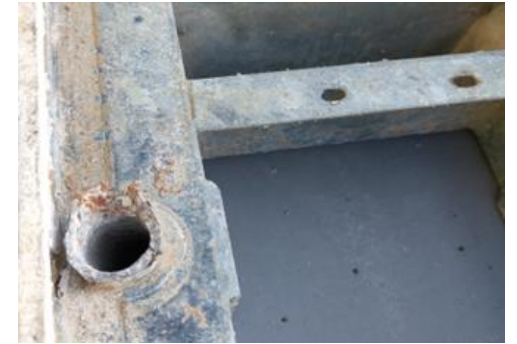
Ontbrekende of beschadigde ankerbescherming
