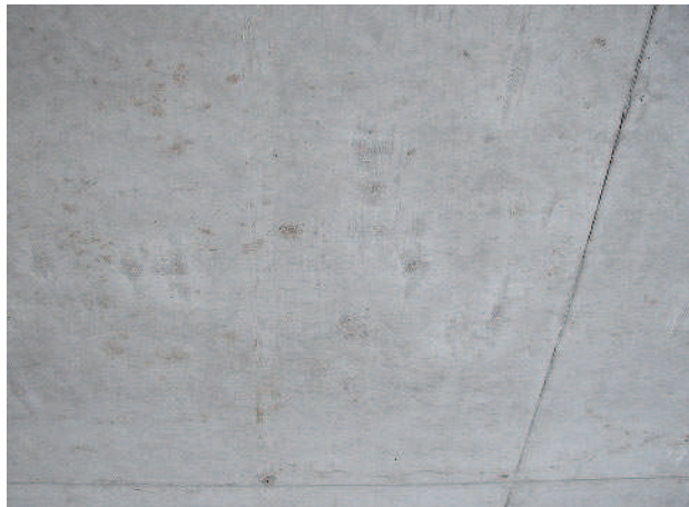
Szennyeződött födém vibrátor által okozott sérüléssel
