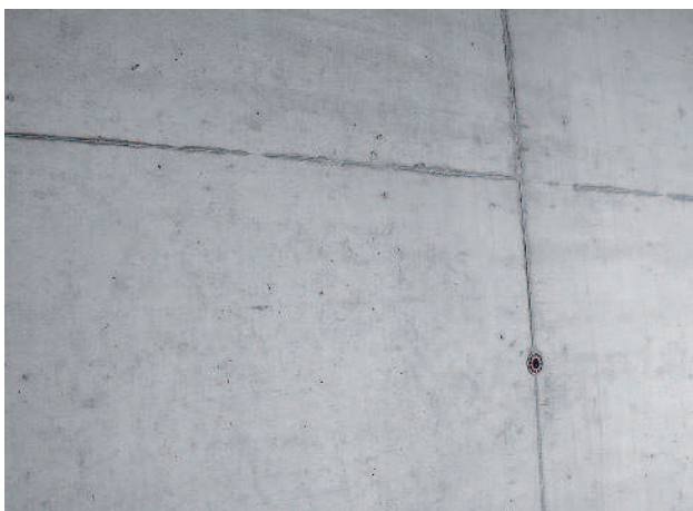
Betonozási kép: Tömítetlen elemillesztés enyhe elemelcsúszással
