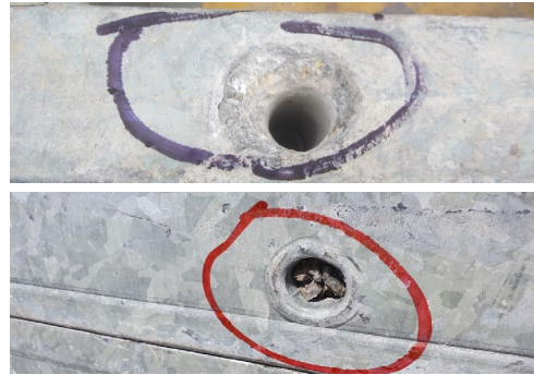
Profielverankeringsgaten beschadigd of vol met beton
