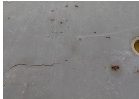
Scheur in bekistingsplaat > 10 cm lengte
