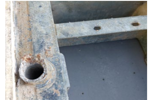
Ontbrekende of beschadigde anker gatbescherming
