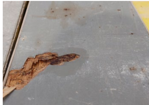
Scheur in bekistingsplaat > 10 cm lengte
