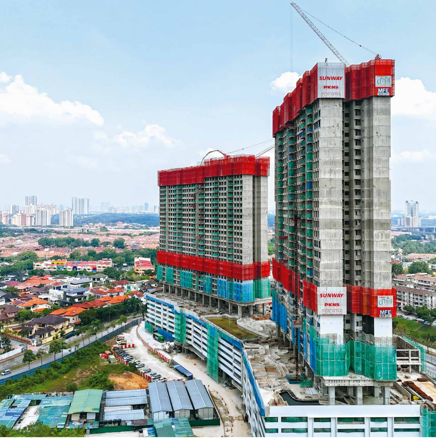
Die Sicherheitslösungen von MFE beim Projekt Sunway d'hill Residences, Malaysia
