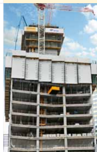
▲ 幅が広い方の駆体では、ビルファサードの形成作業の安全性を確保するために、自動クライミング型枠SKE50 plus 11基を使用しています。幅が狭い方の駆体には、養生スクリーンXclimb 60プラットフォームを使用しています。
